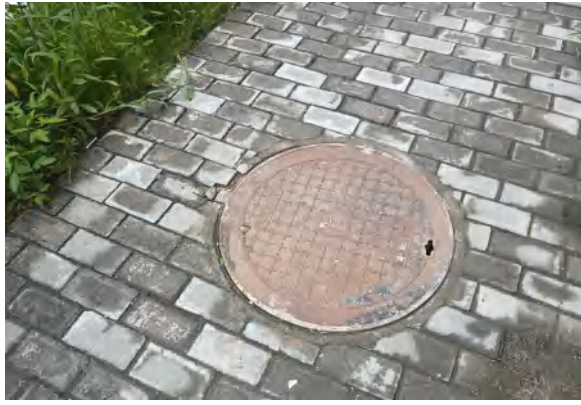
站内污水井盖
