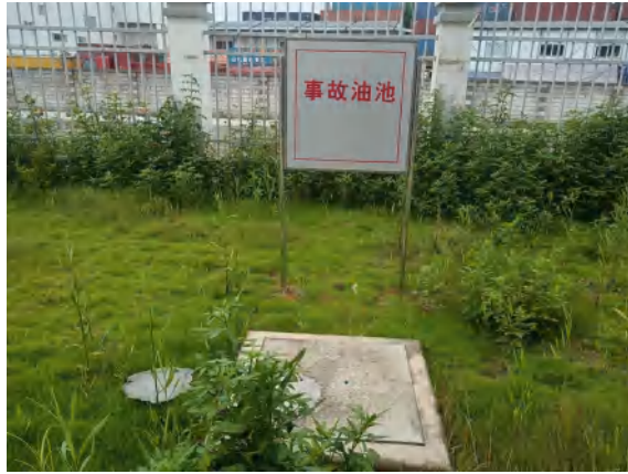
站内事故油池
