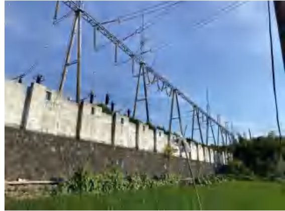
宏山 220kV 变电站间隔扩建侧
