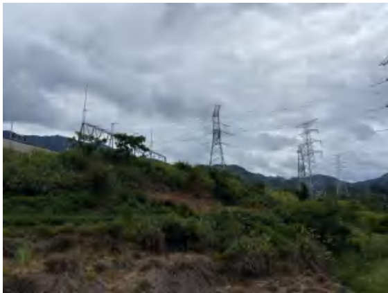
松阳 220kV 变电站间隔扩建侧
