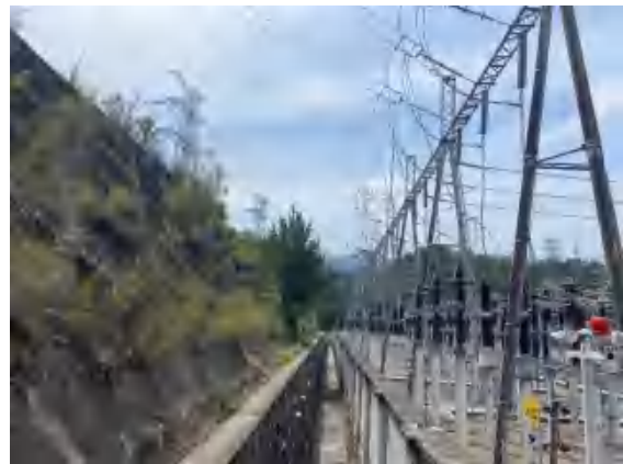
睦田 220kV 变电站间隔扩建侧
