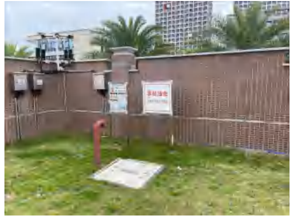
站内事故油池
